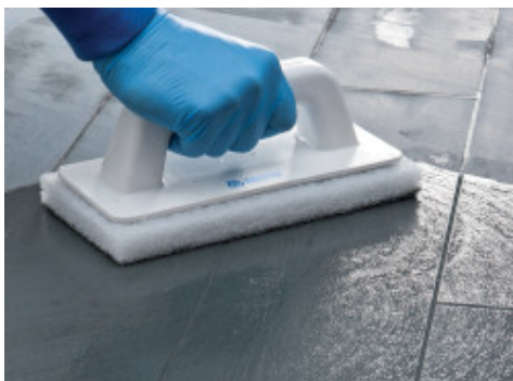
Reinigen van voegen met een Scotch-Brite® spons (wanneer het product half uitgehard is)
